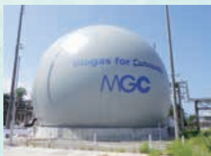
原料の消化ガスタンク
