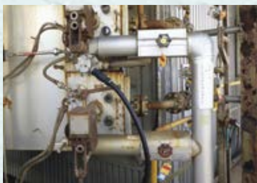
ボイラースチームインジェクション (スチーム吹込により窒素酸化物を低減します)
