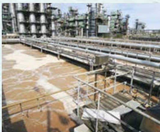
活性汚泥装置 (微生物の働きを利用し、汚水を浄化します)
