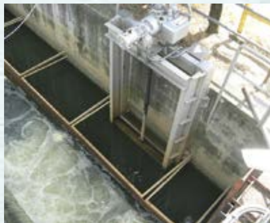
総合排水路出口の遮断弁 (異常排水を新井郷川に流さないための設備です)
