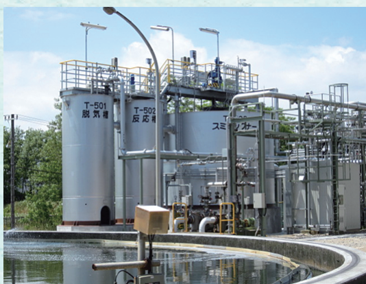
高速凝集沈殿装置 (汚泥を沈降させ、澄明な上水を放流します)
