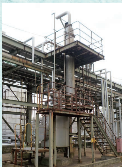
MMA (メタクリル酸メチル) 廃ガス吸収塔
