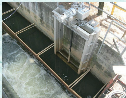
総合排水路出口の緊急遮断弁 (異常排水を新井郷川に流さないための設備です)
