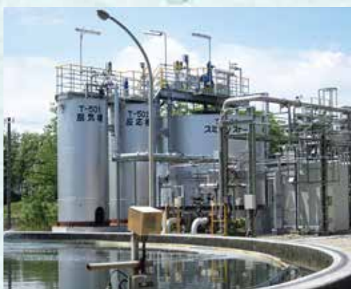
高速凝集沈殿装置
