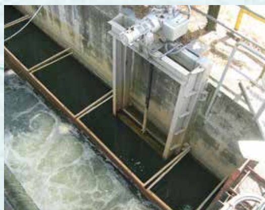
総合排水路出口の緊急遮断弁
