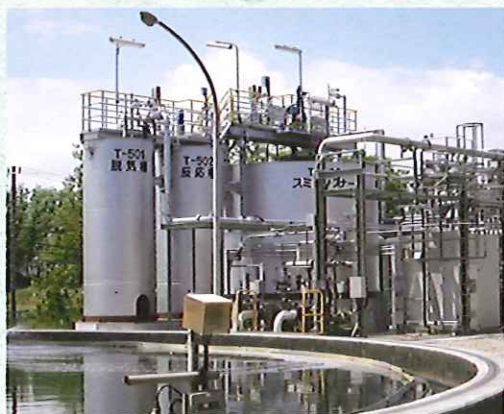
高速凝集沈殿装置 (汚泥を沈降させ、澄明な上水を放流します)
