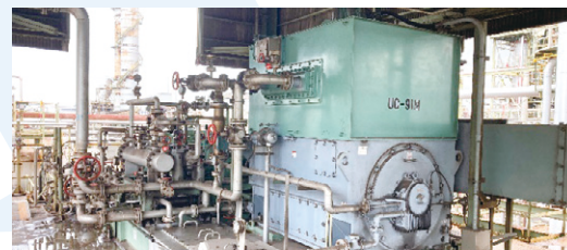
データ解析ツールで最適運転を達成した冷凍機
