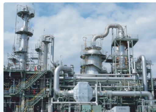
消費電力量削減に繋がった大型コンプレッサ
