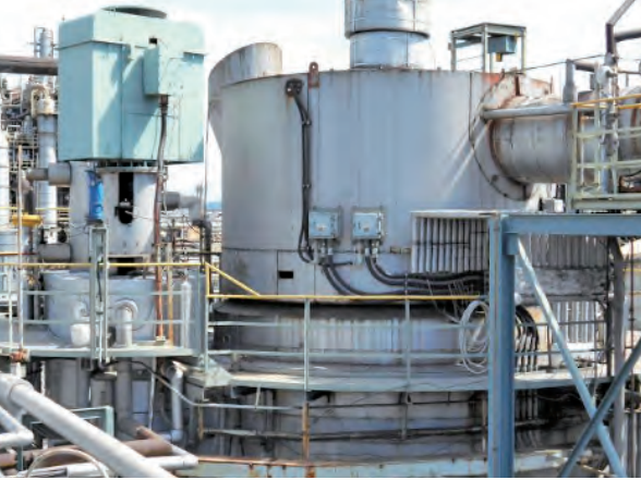
保温強化により発生蒸気量増加を達成した反応器
