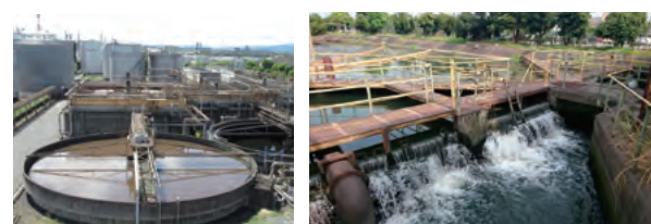
活性汚泥処理設備
