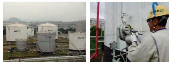
屋外貯蔵タンク
