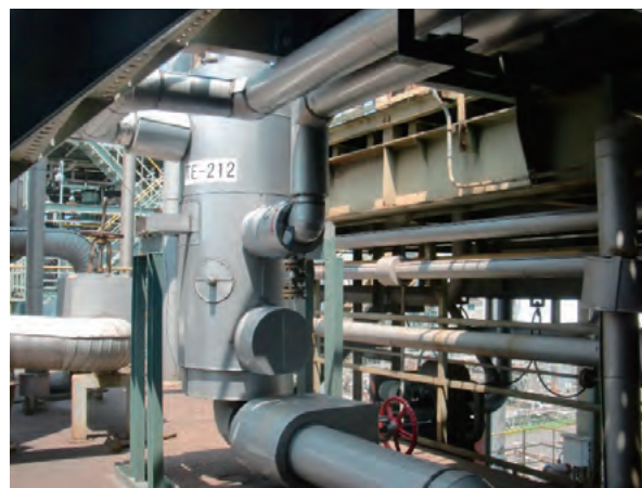
温水熱利用新設熱交換器
