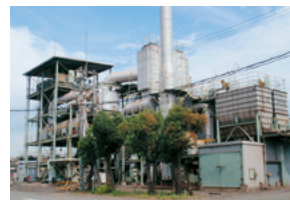
余剰汚泥焼却処理施設
