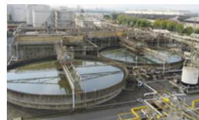
活性汚泥処理設備
