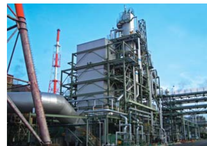
水島工場 新設排気再燃ボイラー
