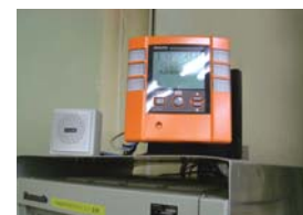
緊急地震速報受信と構内放送を連動させたシステム
