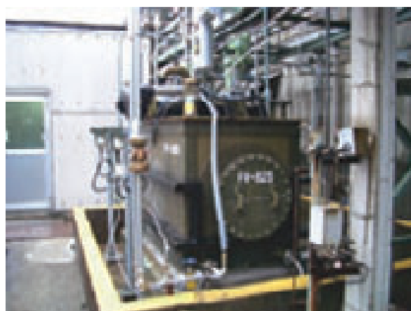
排ガス除害設備
