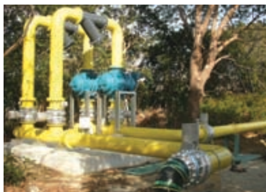
都市ガス受け入れ配管（四日市工場）
