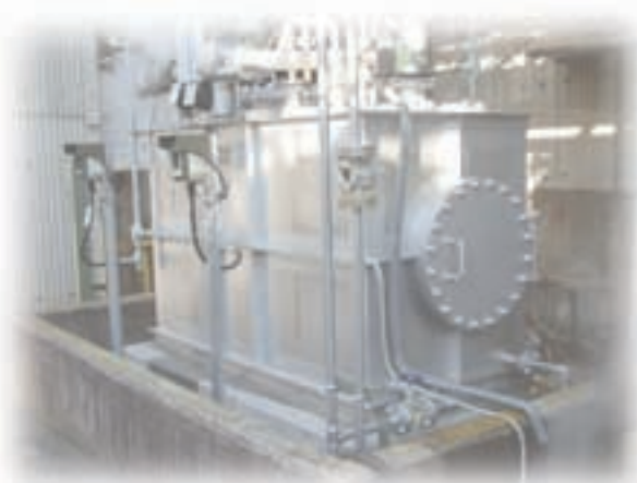
排ガス除害設備
