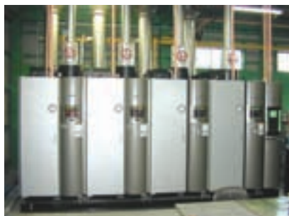
ボイラー燃料転換のSOx削減 (永和化成工業(株))
