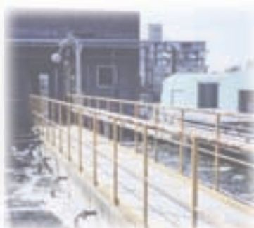
活性汚泥処理装置
