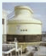
水処理剤を注入する冷却塔
