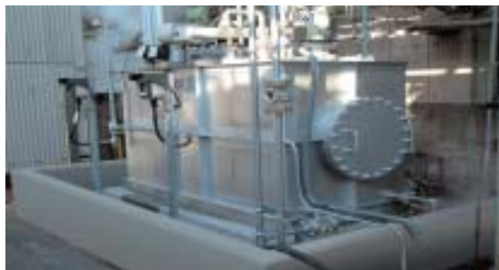
排ガス除害設備
