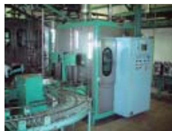
製品充填部の密閉化 （四日市工場）
