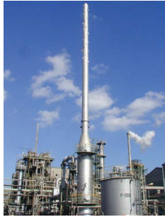
公害防止関連投資 プロセス排ガスの 触媒燃焼無害化設備
