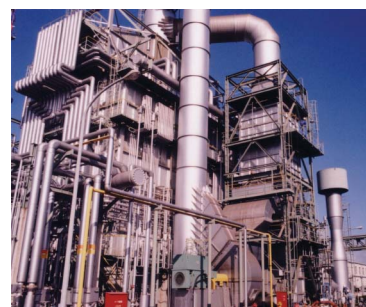
水島工場 排煙脱硝装置
