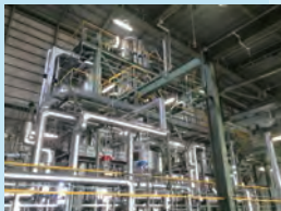
環境循環型メタノールのパイロット設備(新潟工場)
