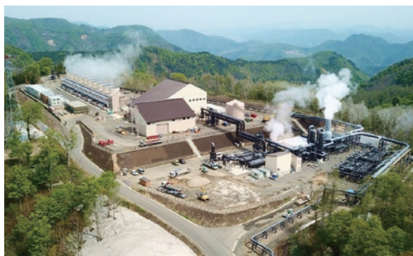
山葵沢地熱発電所(全景)
