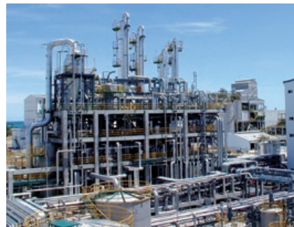
現在稼働中のポリアセタールプラント
