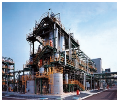
過酸化水素製造プラント
