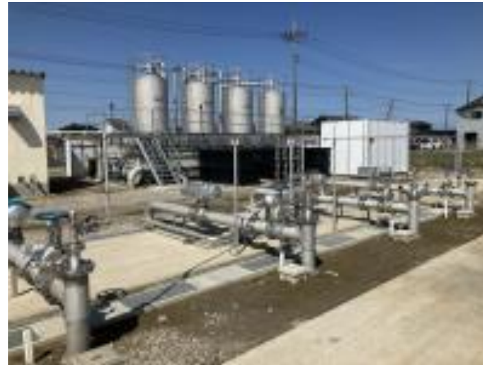
水溶性天然ガス生産設備
