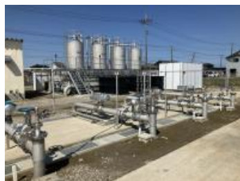
水溶性天然ガス生産設備
