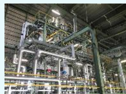
CO 2 原料のメタノール製造技術
