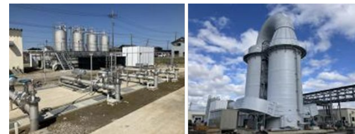
(左)天然ガス生産設備、(右)ヨウ素濃縮プラント 提供:(株)東邦アーステック
