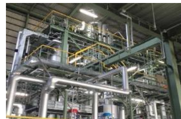
環境循環型メタノール検討用 パイロットプラント
